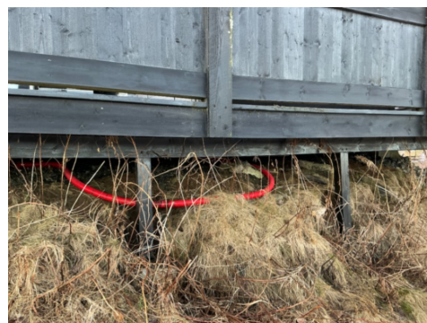
Skjevhet/sig under boblekar.
