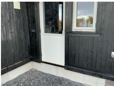
Ingen trapp ved vaskerom.
