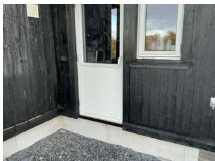
Ingen trapp ved vaskerom.
