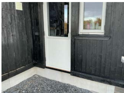
Ingen trapp ved vaskerom.
