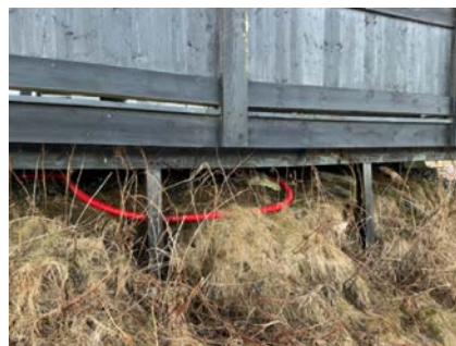
Skjevhet/sig under boblekar.
