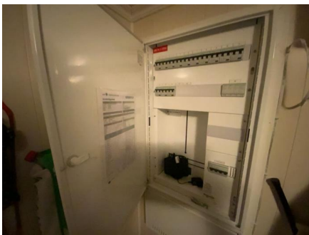
El-skap med automatsikringer. Skap montert i utvendig bod.
