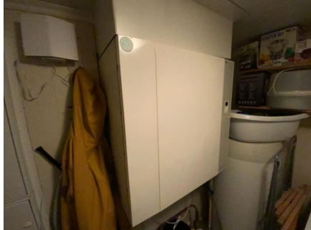
Ventilasjonsaggregat montert i utvendig bod.
