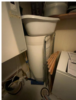
Varmtvannsbereder montert i utvendig bod.
