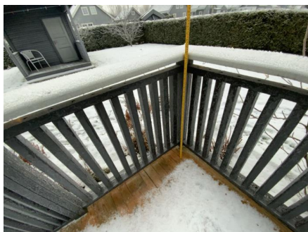
Avvik i rekkverkshøyde ut ifra dagens forskrifter.
