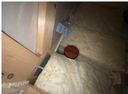
Oppstikk for radonbrønn inne på kott:
