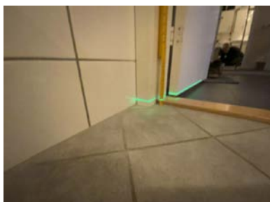
Avvik i krav/anbefaling om høydeforskjell fra topp slukrist til gulv. Målt 20mm
