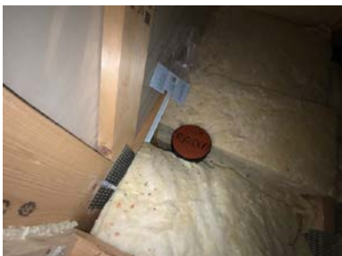
Oppstikk for radonbrønn inne på kott:
