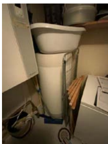
Varmtvannsbereder montert i utvendig bod.
