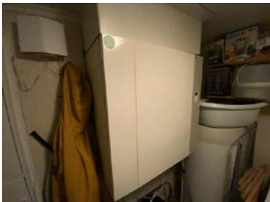
Ventilasjonsaggregat montert i utvendig bod.
