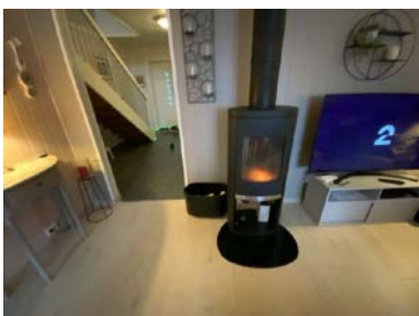
Ildsted med stålpipes.
