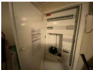
El-skap med automatsikringer. Skap montert i utvendig bod.
