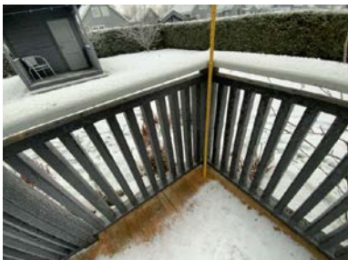
Avvik i rekkverkshøyde ut ifra dagens forskrifter.
