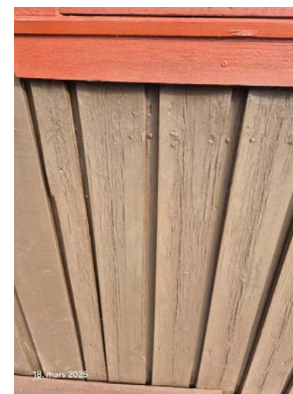
Eksempelbilde av slitt kledning.
