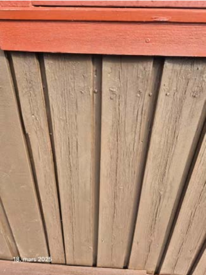
Eksempelbilde av slitt kledning.
