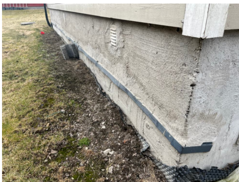
Grunnmursplast er fjernet fra klemlist.
