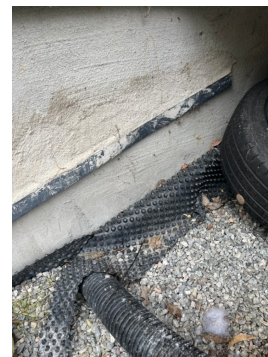
Grunnmursplast har løsnet fra klemlist.
