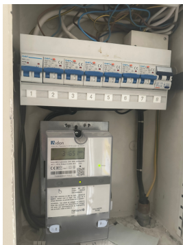
Sikringskap med automatsikringer.
