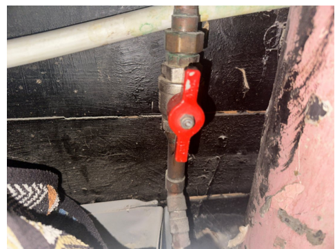
Stoppekraner plassert på bad
