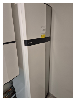
Nibe avtrekksvarmepumpe i teknisk rom.
