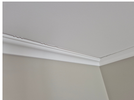
Gliper mellom taklist og takplate.
