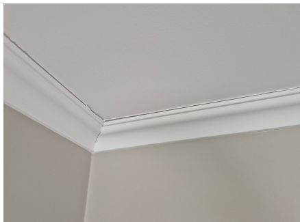
Gliper mellom taklist og takplate.
