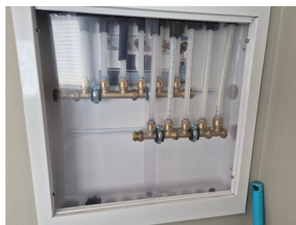
Rørfordelerskap i vaskerom.
