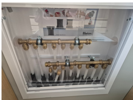
Rørfordelerskap i walk-in closet.
