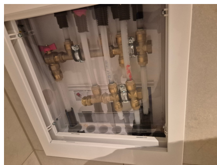
Rørfordelerskap på bad i hybel.
