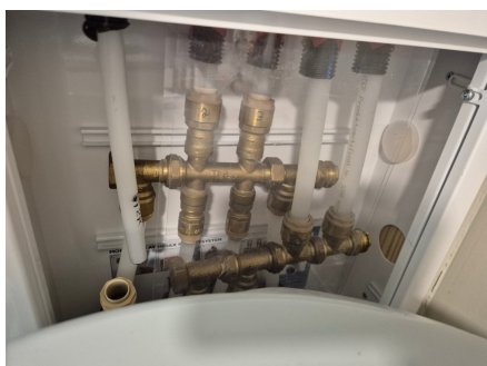
Rørfordelerskap i teknisk rom.
