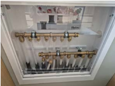
Rørfordelerskap i walk-in closet.
