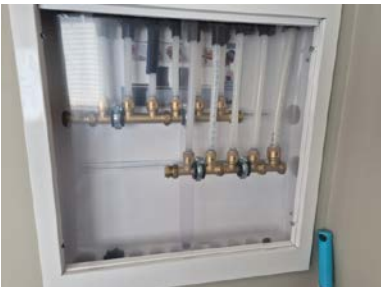
Rørfordelerskap i vaskerom.
