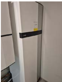
Nibe avtrekksvarmepumpe i teknisk rom.
