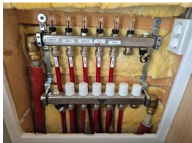
Rørskap i walk-in closet.
