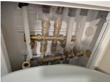
Rørfordelerskap i teknisk rom.
