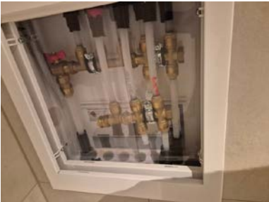
Rørfordelerskap på bad i hybel.
