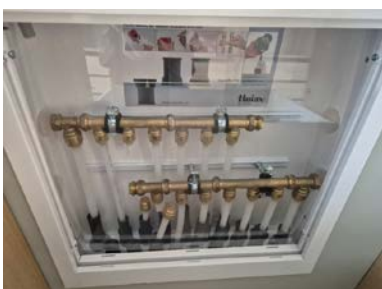
Rørfordelerskap i walk-in closet.
