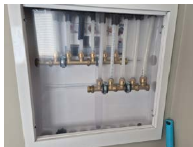
Rørfordelerskap i vaskerom.
