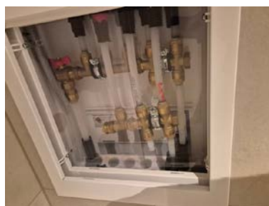
Rørfordelerskap på bad i hybel.
