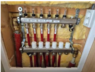
Rørskap i walk-in closet.
