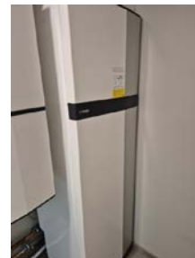
Nibe avtrekksvarmepumpe i teknisk rom.
