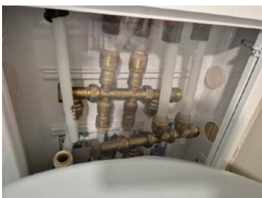
Rørfordelerskap i teknisk rom.
