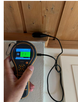
Fuktskjold ved pipestamme, ved fuktmåletaking var det ikke utslag
