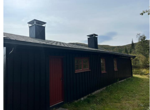
Skjevheter i takkonstruksjon
