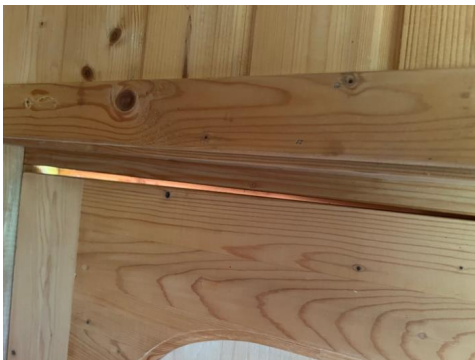
Skjevheter i dør, luftlekkasje i overgang dørblad/karm
