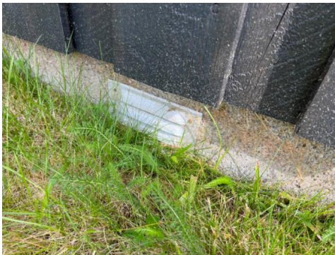
Begrenset ventilering, dels tilstengt av terreng over ventilrist
