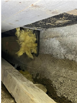
Åpning mot gulvkonstruksjon der det er synlig aktivitet av mus/skadedyr
