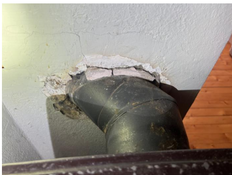
Avskalling rundt røykrør
