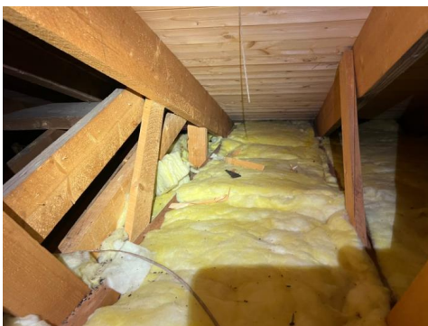
Anbefaler bedre ventilering i takfot
