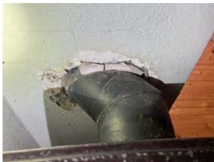
Avskalling rundt røykrør
