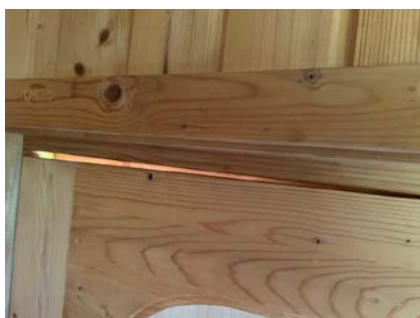
Skjevheter i dør, luftlekkasje i overgang dørblad/karm
