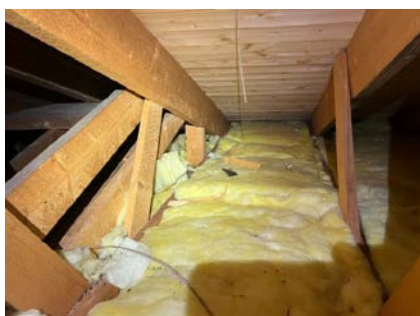
Anbefaler bedre ventilering i takfot
