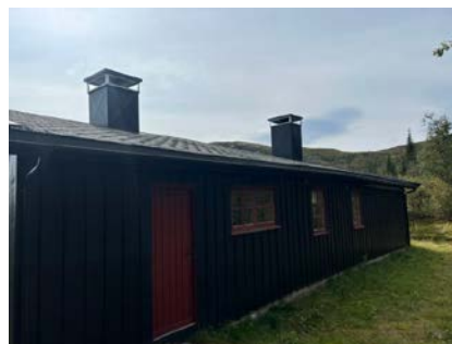
Skjevheter i takkonstruksjon
