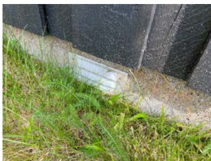
Begrenset ventilering, dels tiltettet av terreng over ventilrist
