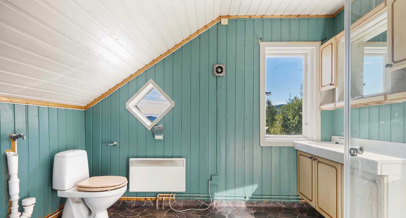
Bad med opplegg for vaskemaskin.
