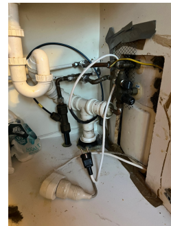
Røropplegg under kjøkkenbenk.
