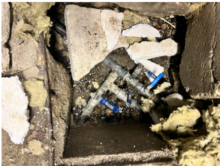
Hovedstoppekraner i krypkjeller
