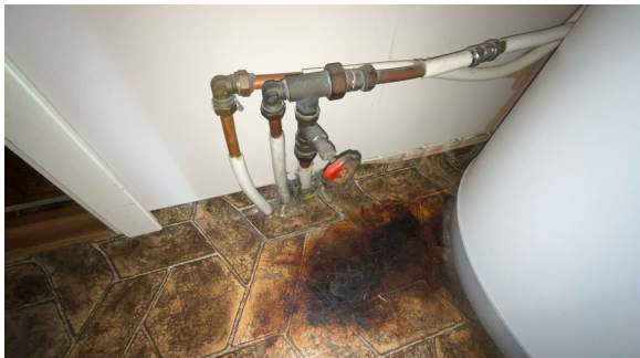
Utsnitt vannrør og stoppekran.
