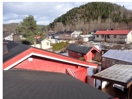
Takutstikk over inngangsparti med noe nedsig/skjevheter. Dette gjelde nedre del mot høyre side.
