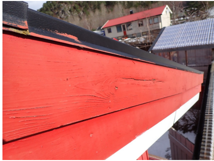
Stedvis påbegynnende råte i vindskiebord.
