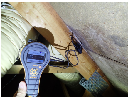
Fuktmerker i undertak ved taggjennomføring. Ingen tegn til aktiv fukt ved fuktmåling i området
