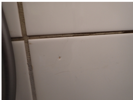
Eksemepl på riss/ sprekk i flisefuger i dusjsonen.
