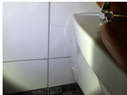
Sprukket veggflis ved toalett.
