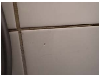
Eksempel på riss/ sprekke i flisefuger i dusjsonen.
