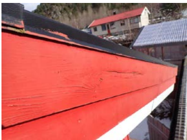
Stedvis påbegynnende råte i vindskiebord.
