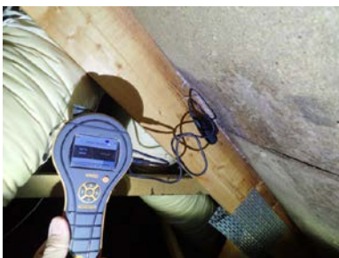
Fuktmerker i undertak ved taggjennomføring. Ingen tegn til aktiv fukt ved fuktmåling i området
