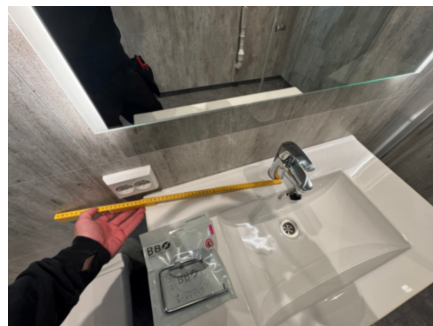
Det er montert stikkontakt i våt sone.
