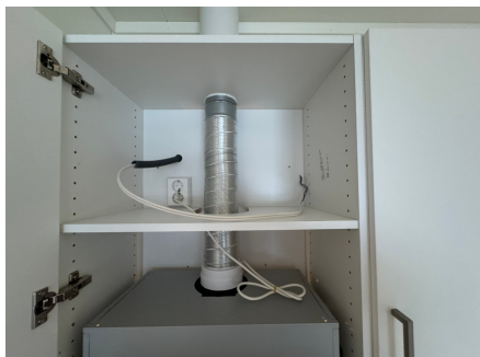
Avtrekket er ikke tilkoblet ventilasjonsanlegget.
