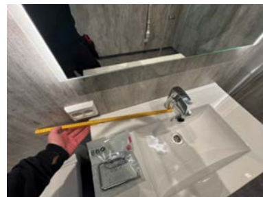
Det er montert stikkontakt i våt sone.
