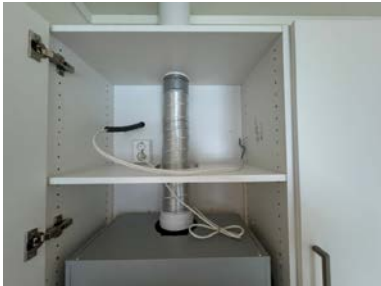
Avtrekket er ikke tilkoblet ventilasjonsanlegget.
