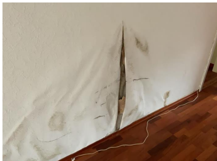
Tapet i stuen med vesentlig fukt-utslag.
