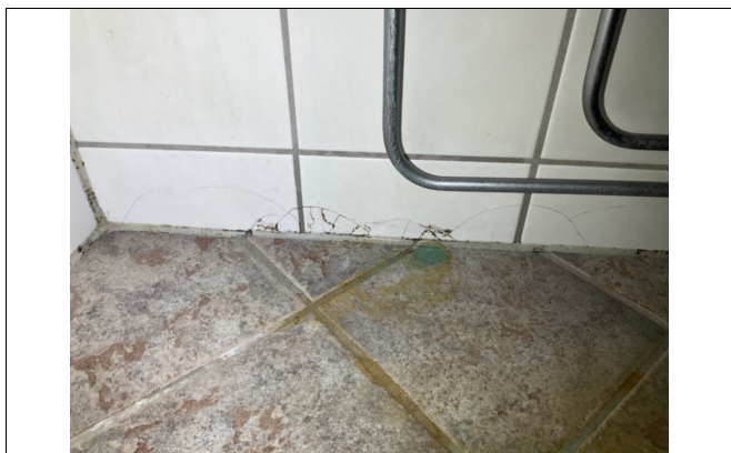
Skade på nedre flisrad i dusj.
