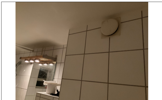
Naturlig avtrekk fra bad.
