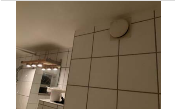
Naturlig avtrekk fra bad.
