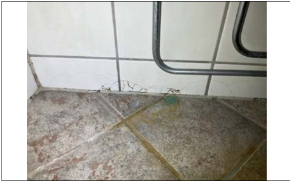
Skade på nedre flisrad i dusj.
