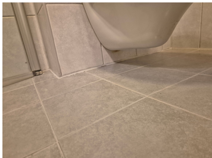
Ingen drensspalte til sisterne.
