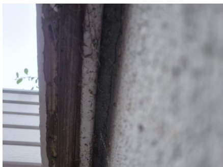
Ingen lufting i nedre del mot øst.
