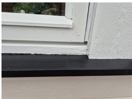
Påbegynt råtne i vinduskarm.
