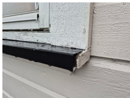
Værslitt treverk og for kort beslag til vannbrett.
