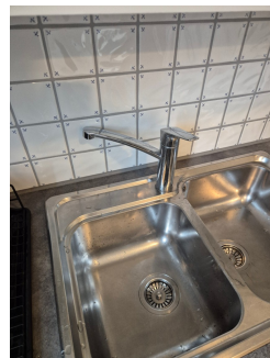
Kjøkkenkranen uten stoppfunksjon.
