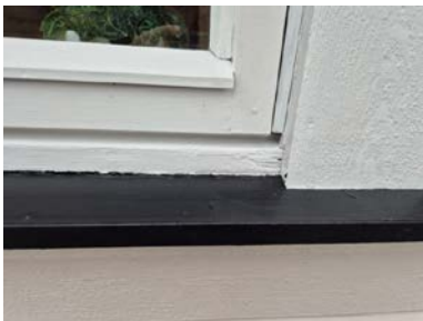
Påbegynt råte i vinduskarm.
