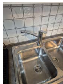
Kjøkkenkranen uten stoppfunksjon.
