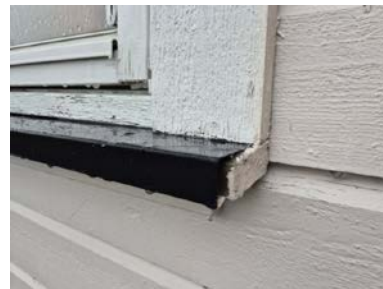
Værslitt treverk og for kort beslag til vannbrett.
