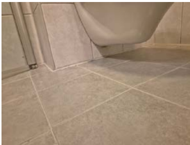
Ingen drensspalte til sisterne.
