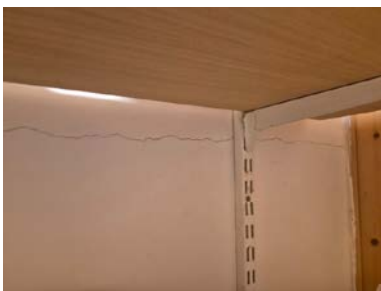
Horisontalriss i bod.
