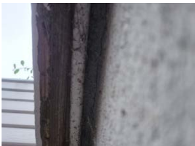
Ingen lufting i nedre del mot øst.
