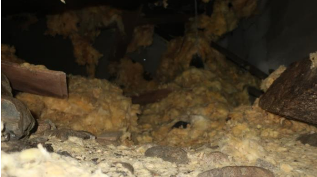
Under entre og våtrom.
