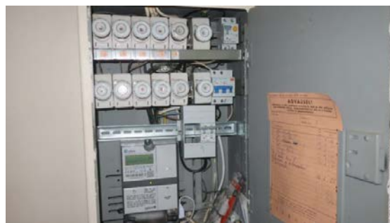
Skrusikringer. Noe oppgradert.
