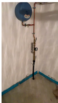
Vanninntak med stoppekran i kjeller.
