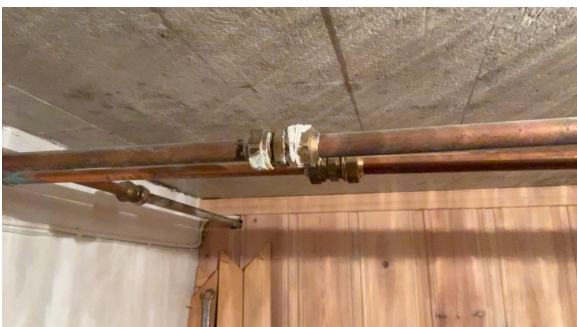
Eksempel på korrosjon på rørsjøter.
