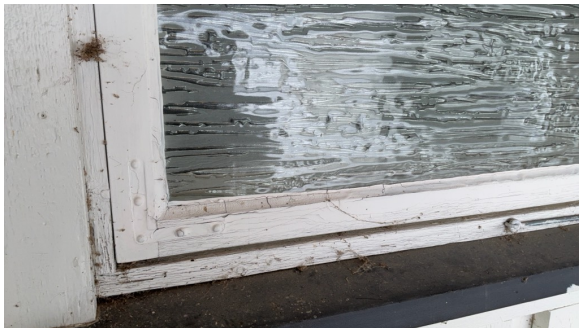
Eksempel på slitasje og oppsprekking i kitt.
