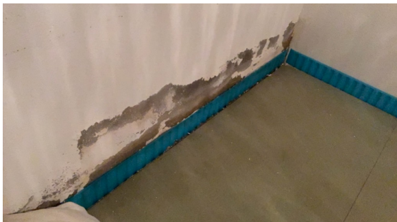
Eksempel på avskaling og saltutslag på vegg.
