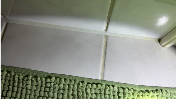
Sprekk i gulvflis.
