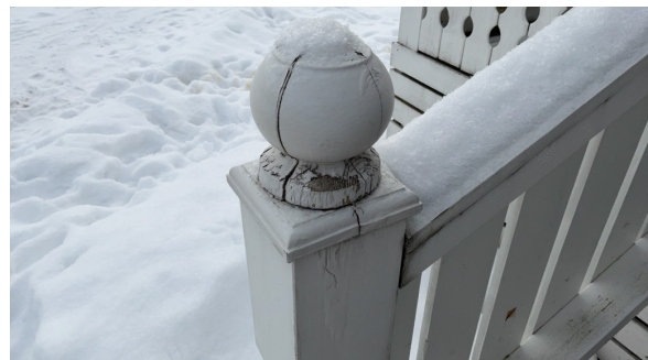
Eksempel på slitasje på veranda ved entre.
