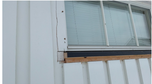
Eksempel på sprekk i kledningsbord.
