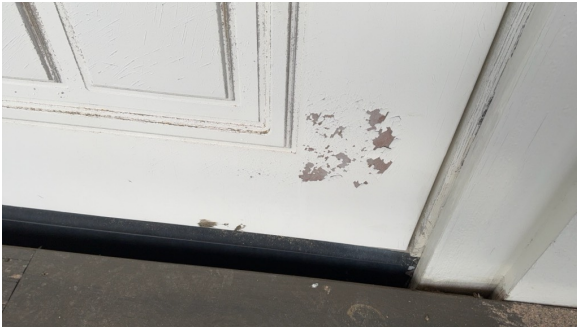
Slitasje på sekundær entredør.
