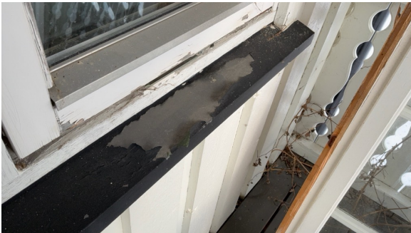
Eksempel på avskaling på beslag
