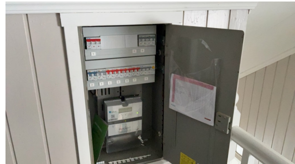
Sikringsskap i 2. etasje.
