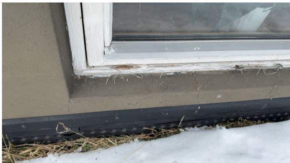
Eksempel på slitasje.
