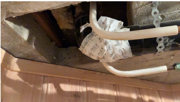
Tape på bend på avløpsrør.
