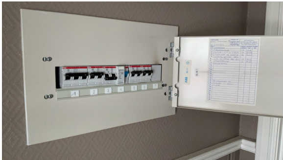
Sikringsskap i tilbygg
