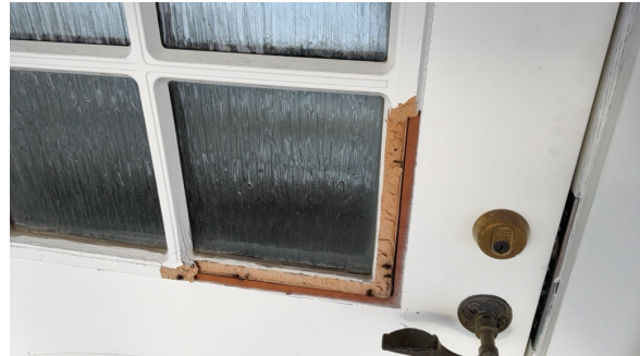
Slitasje på sekundær entredør.
