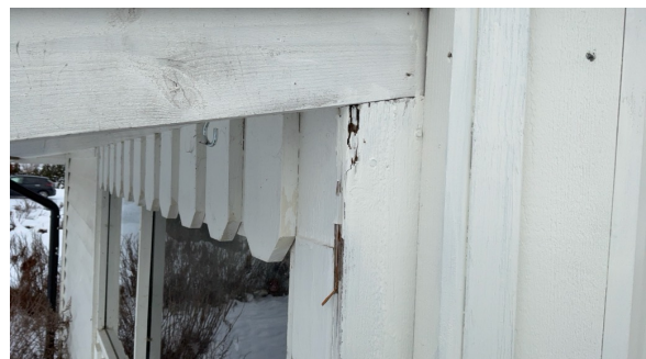
Råte på innebygget veranda.
