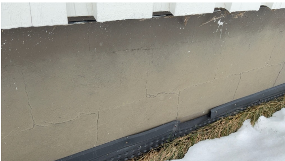
Eksempel på sprekk/riss.
