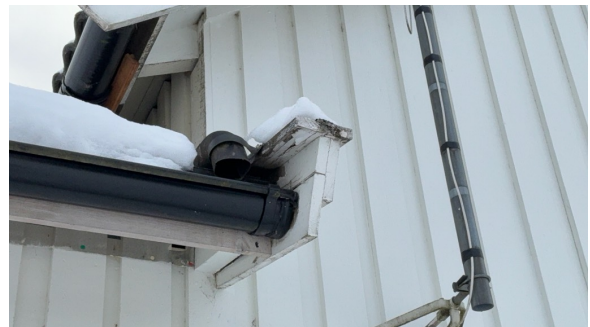
Eksempel på slitasje.
