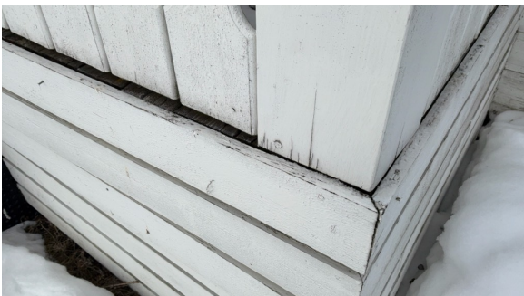
Eksempel på slitasje på veranda ved entre.
