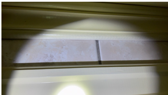
Eksempel på sprekk i fuge
