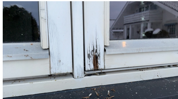
Vindu med råte mot nord.
