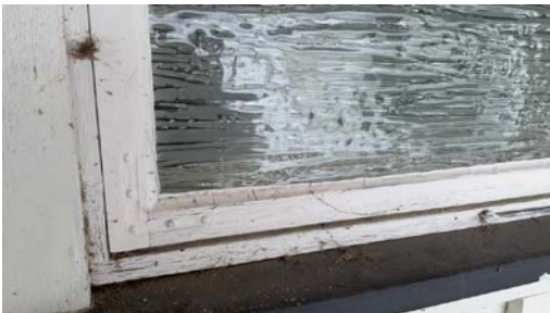
Eksempel på slitasje og oppsprekking i kitt.
