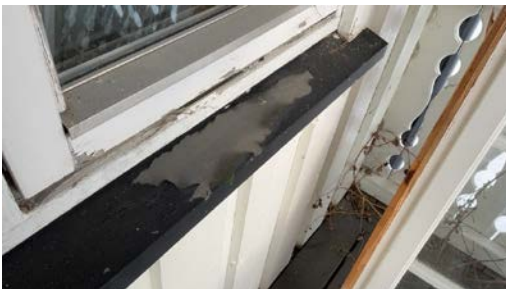
Eksempel på avskaling på beslag
