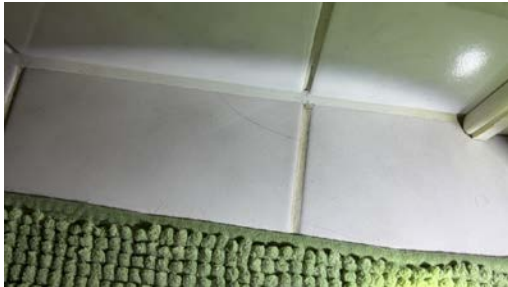
Sprekk i gulvflis.
