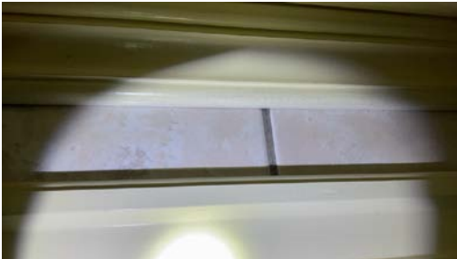
Eksempel på sprekk i fuge
