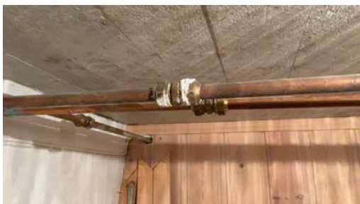
Eksempel på korrosjon på rørsjøter.
