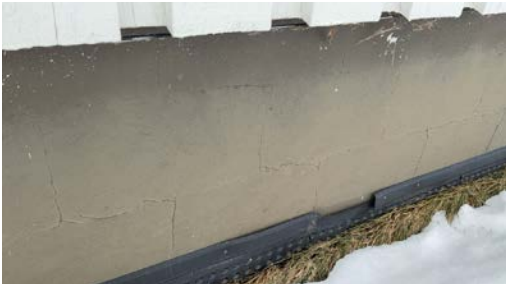
Eksempel på sprekk/riss.
