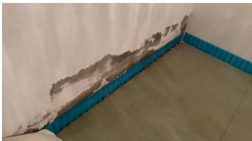
Eksempel på avskaling og saltutslag på vegg.
