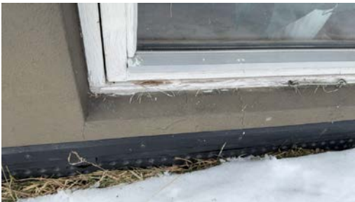
Eksempel på slitasje.
