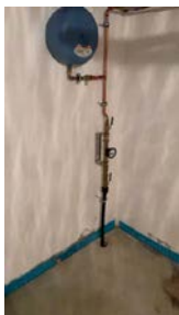
Vanninntak med stoppekran i kjeller.
