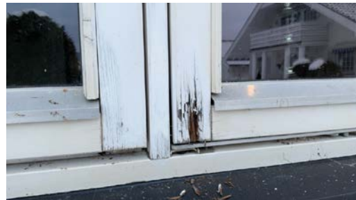
Vindu med råte mot nord.
