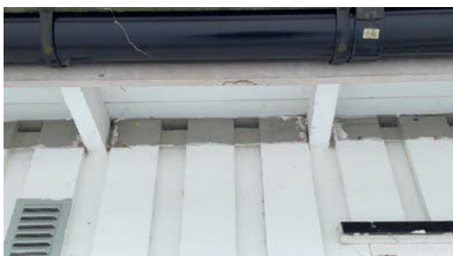
Lufting mellom tak og vegg, det er stiftet på netting på utsiden.
