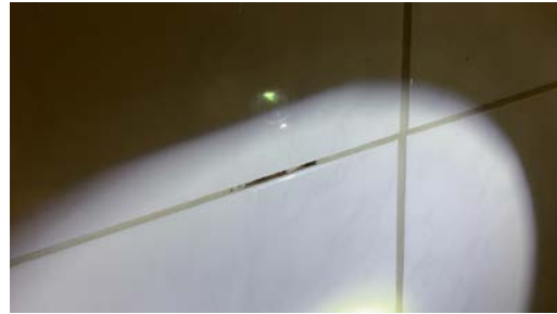
Oppsmuldring i hardfuge på vegg på ett sted.
