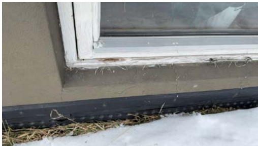
Eksempel på slitasje.
