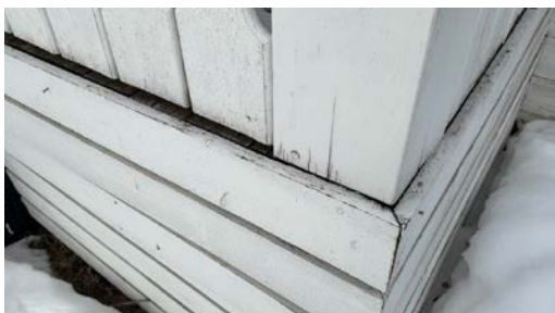
Eksempel på slitasje på veranda ved entre.
