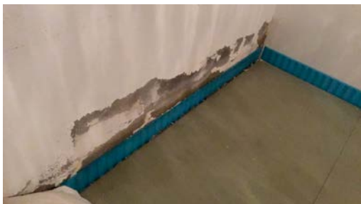
Eksempel på avskaling og saltutslag på vegg.
