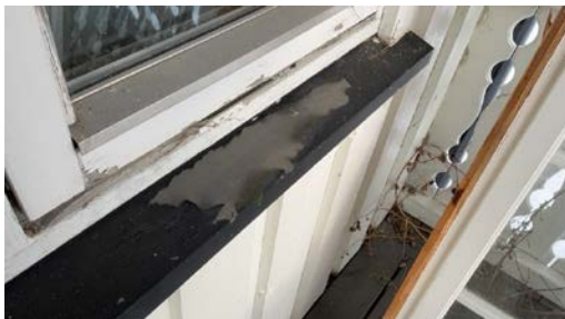
Eksempel på avskaling på beslag
