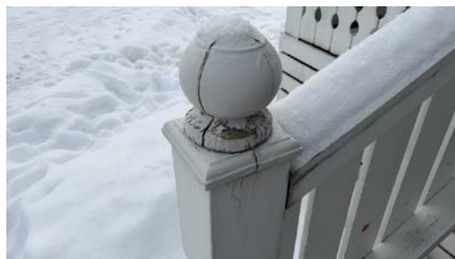
Eksempel på slitasje på veranda ved entre.
