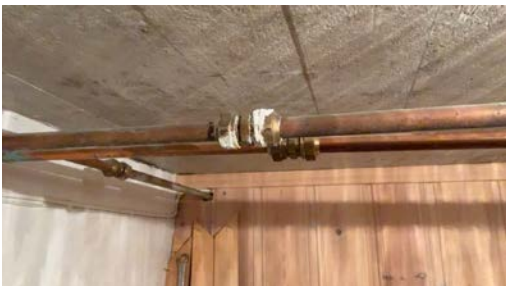
Eksempel på korrosjon på rørsjøter.
