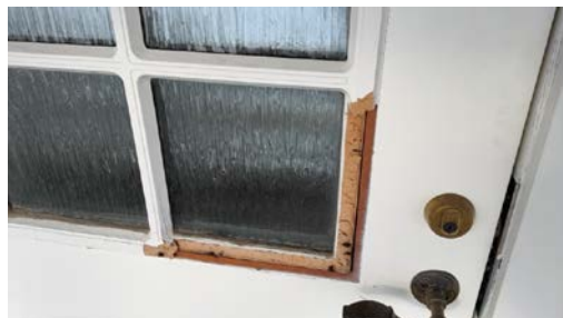
Slitasje på sekundær entredør.
