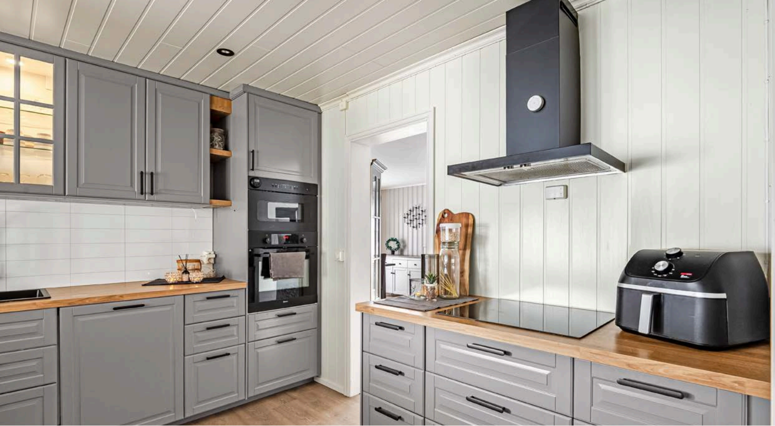
Kjøkkenventilator med kullfilter er installert over platetoppen.
