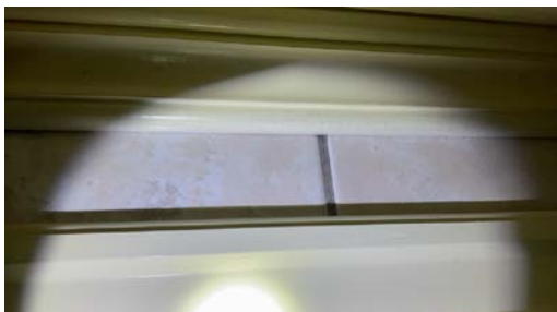
Eksempel på sprekk i fuge
