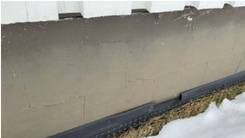
Eksempel på sprekk/riss.
