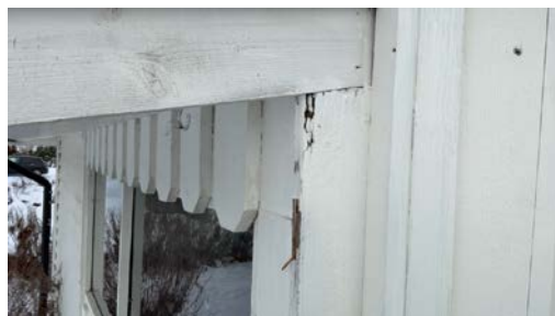
Råte på innebygget veranda.
