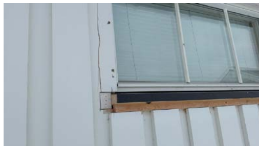
Eksempel på sprekk i kledningsbord.
