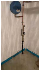
Vanninntak med stoppekran i kjeller.
