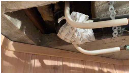
Tape på bend på avløpsrør.
