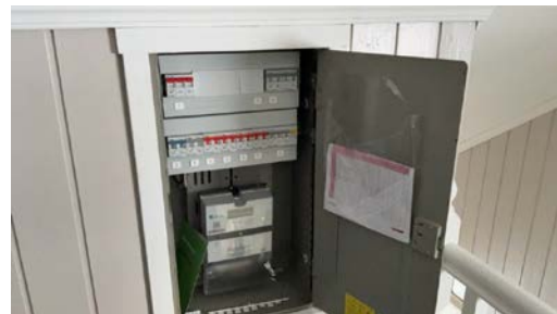
Sikringsskap i 2. etasje.
