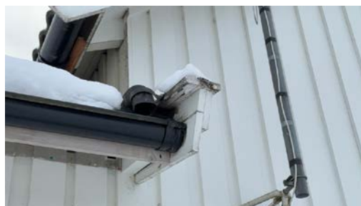
Eksempel på slitasje.
