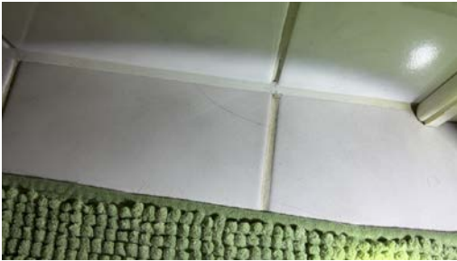
Sprekk i gulvflis.
