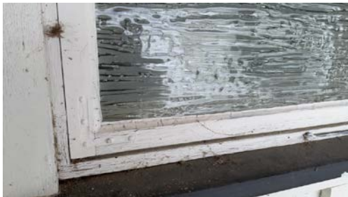
Eksempel på slitasje og oppsprekking i kitt.
