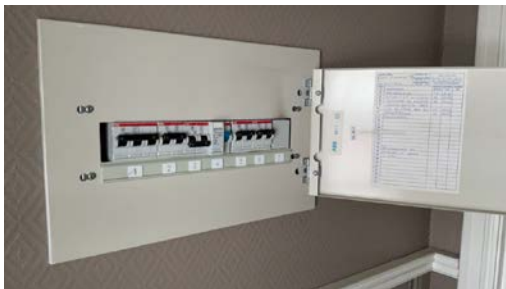
Sikringsskap i tilbygg
