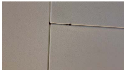
Synlig innfesting på takesseplate.
