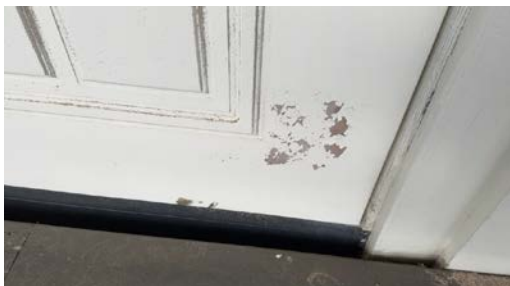
Slitasje på sekundær entredør.
