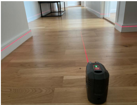
Nivellering entré/gang, avvik 30 mm gjennom hele rommet
