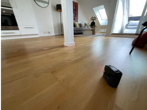
Nivellering stue/kjøkken, 30 mm avvik gjennom hele rommet
