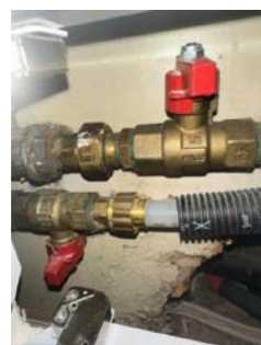
Stoppekraner for kjøkken plassert på soverom
