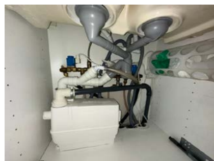
Røropplegg i kjøkkenbenk med Waterguard og pumpe for avløp
