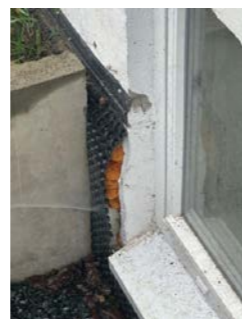
Glippe fra grunnmurspapp mot vindu
