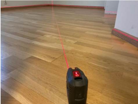
Nivellering soverom, avvik ca. 15-30 mm
