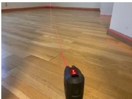
Nivellering soverom, avvik ca. 15-30 mm
