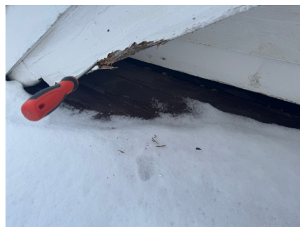
Eksempel på råteskade.
