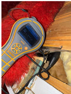
Fuktmåling i svill bak dusjkabinettet.
