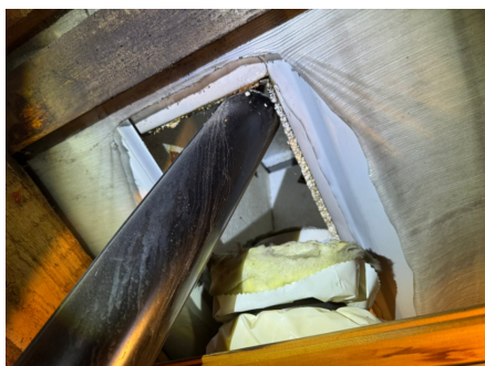
Ventilasjonsrør er avsluttet langt nede.
