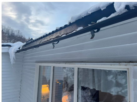
Eksempel på deformasjoner i takrenner.
