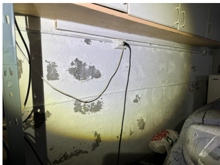
Saltutslag på vegg i garasjen.
