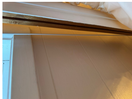
Ventil innvendig er kledd over med plater.
