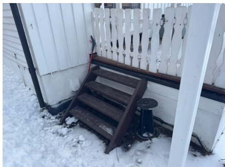
Trapp uten rekkverk.
