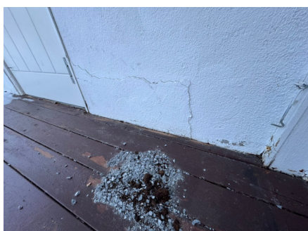
Eksempel på sprekk i grunnmuren.
