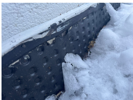
Eksempel på skade på utvendig fuktsikring
