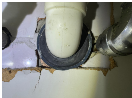
Eksempel på utettheter rundt gjennomføringer i våt sone.
