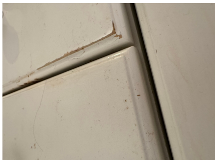
Fuktsvelling på baderomsinnredningen.
