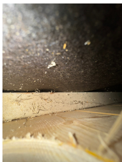
Innvendig i vegg hvor fuktmålingen er foretatt.
