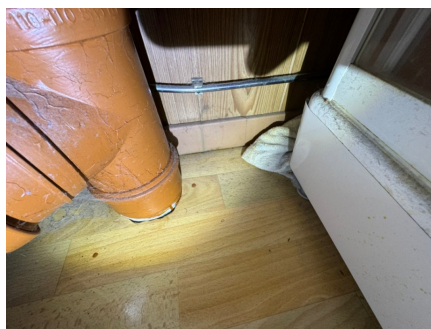
Eksempel på utett rørgjennomføring.
