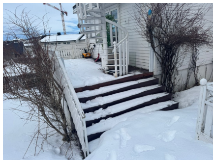
Mangler rekkverk på en side.
