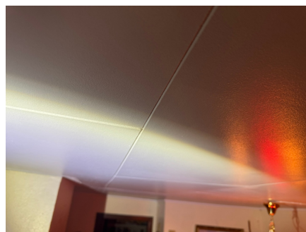
Himlingsplater i taket i underetasjen er løse.
