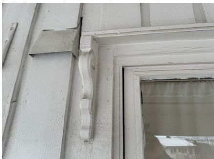
Ventil utvendig på soverommet.
