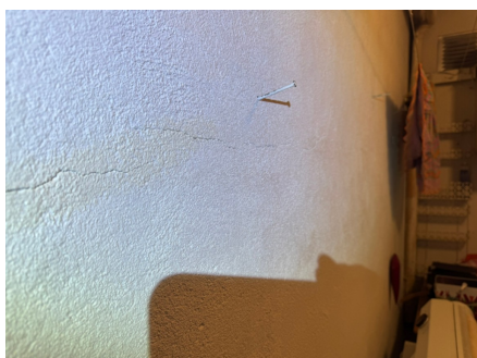
Horisontal riss i grunnmuren.
