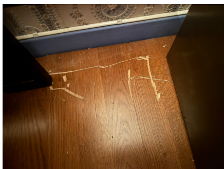
Eksempel på slitasje/skader utover normal slitasjegrad.
