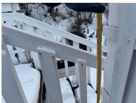
Lavt rekkverk mot trappen.
