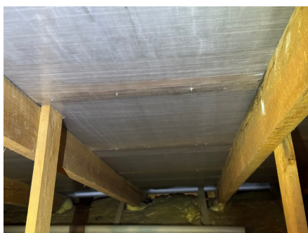
Eksempel på skader i undertaket.
