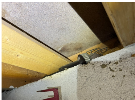
Tegn til fukt fra undersiden av membranen.
