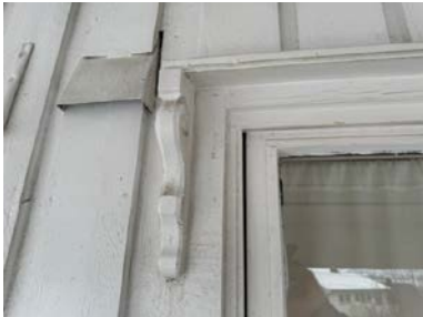
Ventil utvendig på soverommet.
