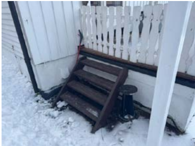
Trapp uten rekkverk.
