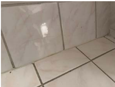
Eksempel på skadet flis.
