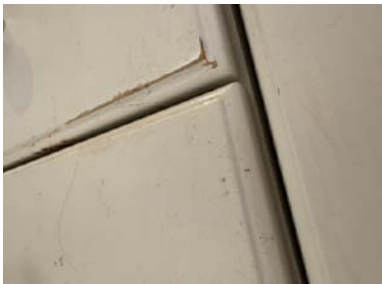
Fuktsvelling på baderomsinnredningen.
