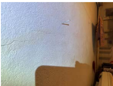
Horisontal riss i grunnmuren.
