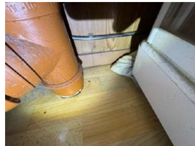
Eksempel på utett rørgjennomføring.
