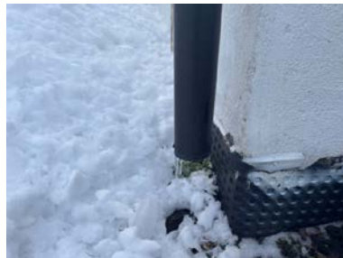
Nedløp som er avsluttet ved grunnmuren.
