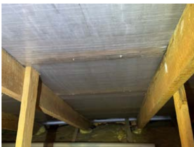
Eksempel på skader i undertaket.
