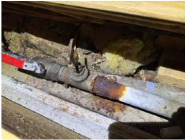
Vannrørret har rustskader.
