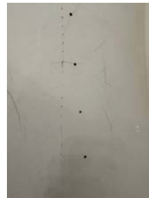
Eksempel på riss i utstyr på våtrommet.
