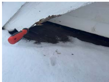
Eksempel på råteskade.
