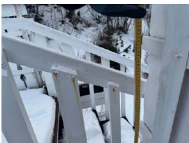
Lavt rekkverk mot trappen.
