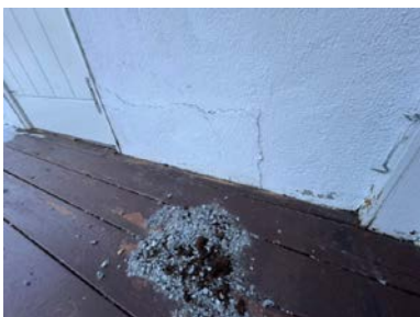
Eksempel på sprekk i grunnmuren.
