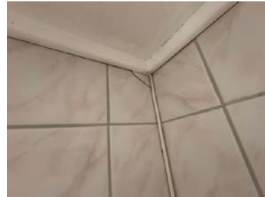
Eksempel på skadet flis.
