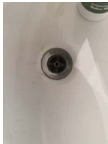
Eksempel på riss i utstyr på våtrommet.
