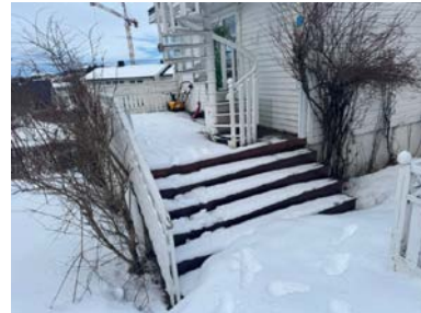
Mangler rekkverk på en side.
