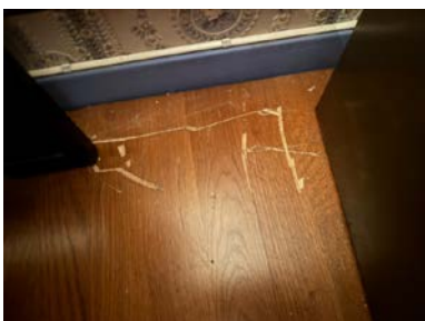
Eksempel på slitasje/skader utover normal slitasjegrad.
