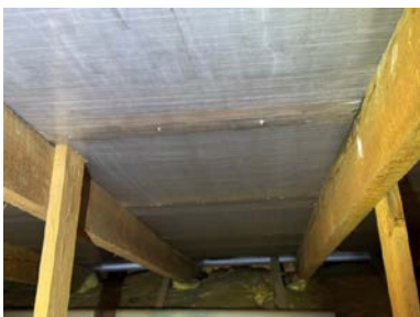
Eksempel på skader i undertaket.
