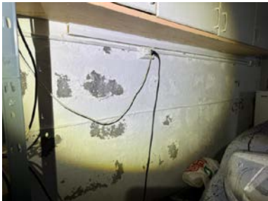
Saltutslag på vegg i garasjen.
