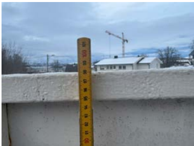
Rekkverket er målt til ca 0,98 meter.
