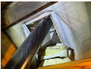
Ventilasjonsrør er avsluttet langt nede.
