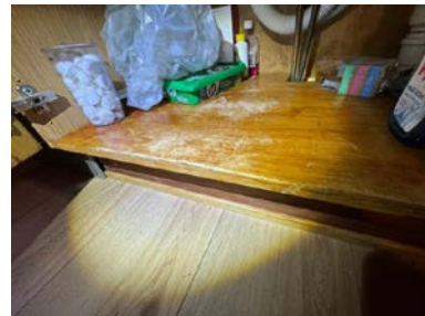
Eksempel på skade.
