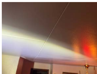
Himlingplater i taket i underetasjen er løse.
