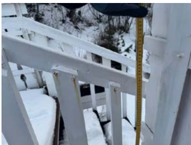
Lavt rekkverk mot trappen.
