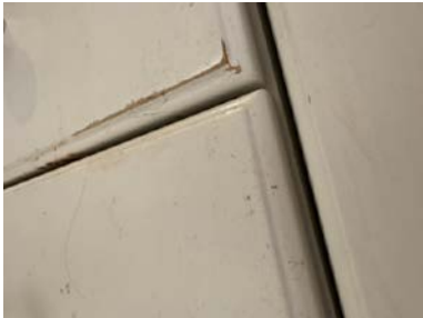
Fuktsvelling på baderomsinnredningen.
