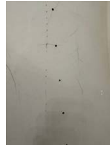
Eksempel på riss i utstyr på våtrommet.
