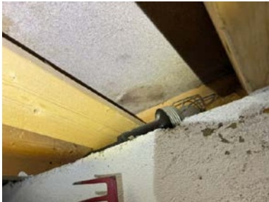
Tegn til fukt fra undersiden av membranen.
