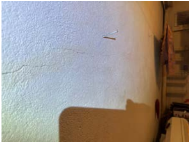
Horisontal riss i grunnmuren.
