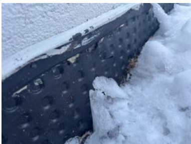
Eksempel på skade på utvendig fuktsikring
