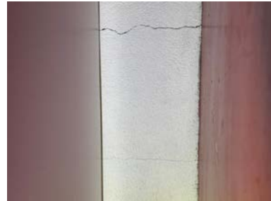
Horisontal riss i grunnmuren.
