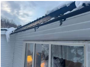
Eksempel på deformasjoner i takrenner.
