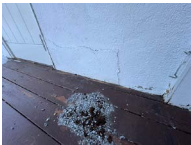
Eksempel på sprekk i grunnmuren.
