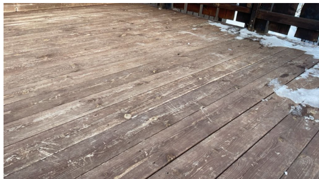
Vedlikeholdsbehov av terrasse mot vestlig retning
