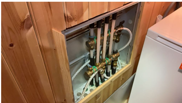
Fordelerskap plassert i rom med sluk
