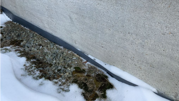
Manglende klemme mot mur
