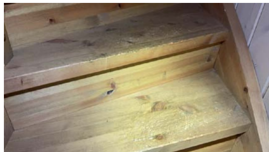
Slitasje i trinn
