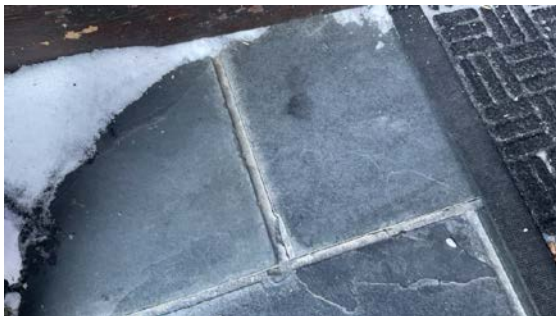
Bemerket bom (hullrom) og sprekkdannelse i fug ved ytterdør.
