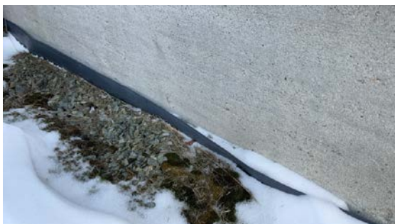
Manglende klemme mot mur
