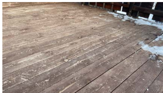
Vedlikeholdsbehov av terrasse mot vestlig retning
