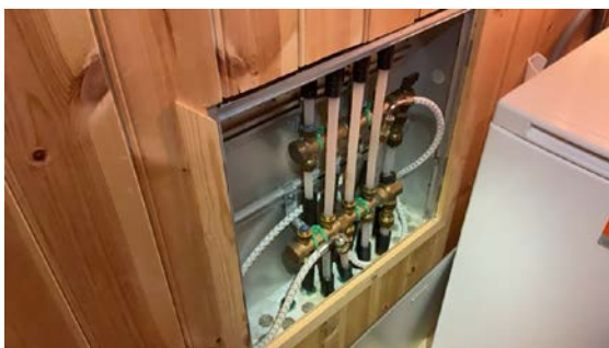
Fordelerskap plassert i rom med sluk
