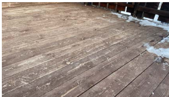
Vedlikeholdsbehov av terrasse mot vestlig retning
