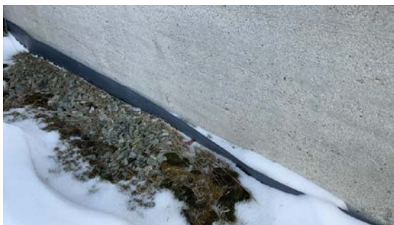
Manglende klemme mot mur
