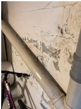
Viser salt/fuktutslag på innsiden av grunnmur i kjellerboder.
