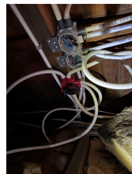
Viser deler av el-opplegget på loft.
