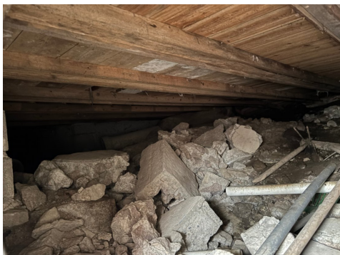
Viser deler av krypkjeller
