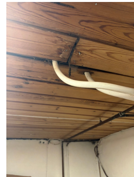
Viser kobberør og skjolder i tak i kjeller
