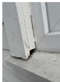
Viser utettheter vedr beslag/vannbrett.
