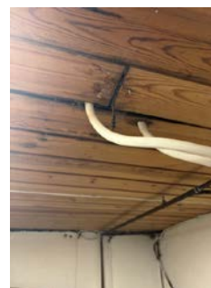
Viser kobberrør og skjolder i tak i kjeller
