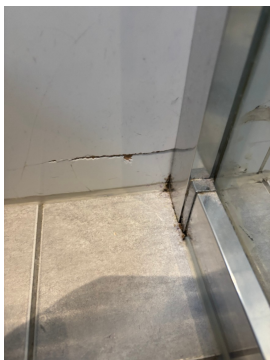
Viser sprekk/skader i veggfliser.
