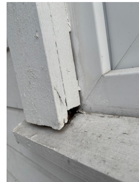
Viser utettheter vedr beslag/vannbrett.
