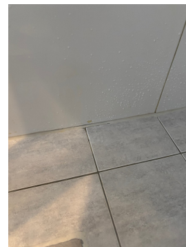
Viser noen glipper/sprekker i silicon.
