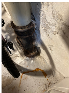
Viser pvc rør som er tilkoblet gammel soil.
