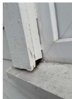
Viser utettheter vedr beslag/vannbrett.
