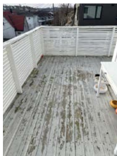
Viser veranda i 1 etg med vedlikeholdsbehov.
