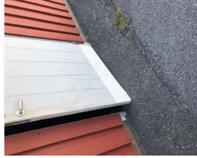
Dør som subber mot terreng
