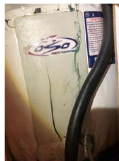
Bilde av deksel på varmtannsbereideren
