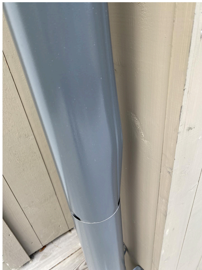
Stedvis frostspreng nederst på nedløp.
