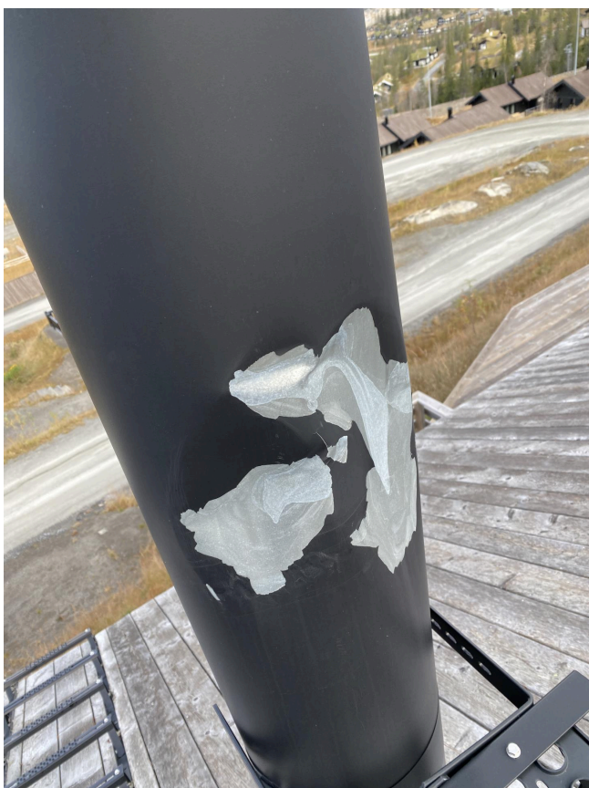
Liten side skade på skorstein.
