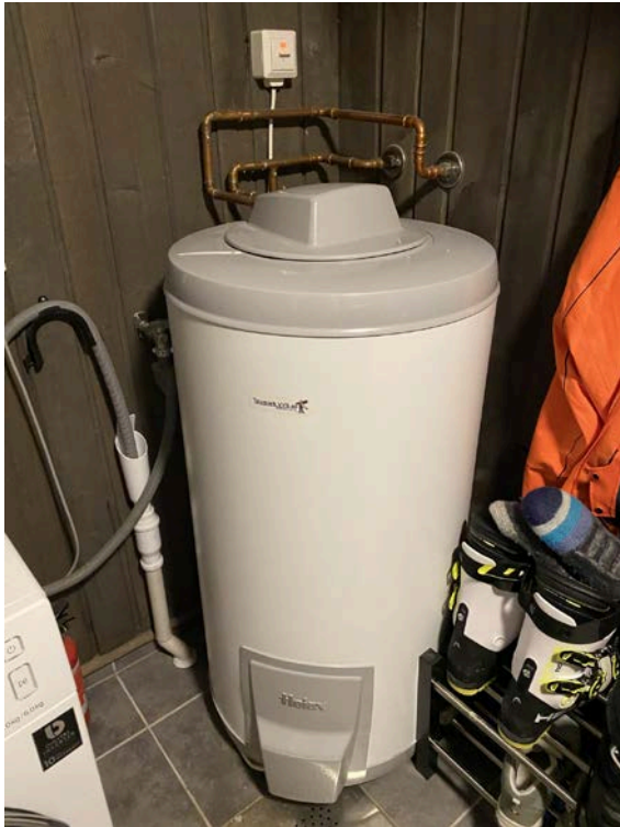
Varmtvannstank fra byggeåret.
