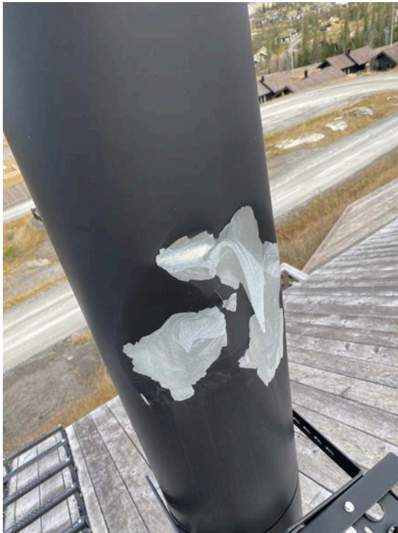
Liten side skade på skorstein.
