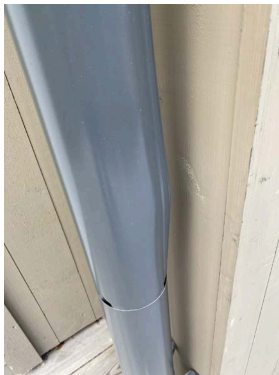
Stedvis frostspreng nederst på nedløp.
