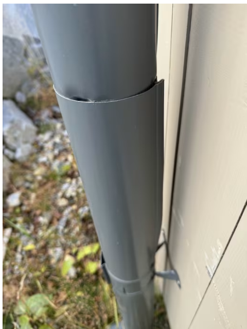
Frostsprenning på nedløpsrør.
