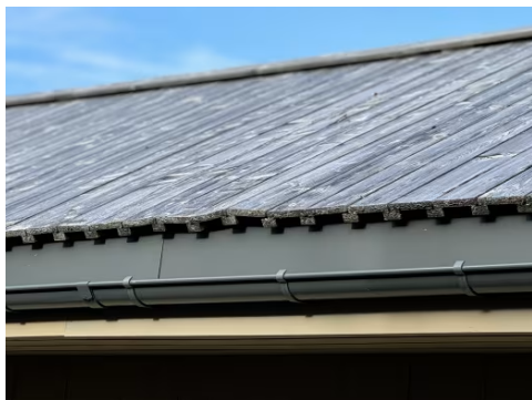
Bordtak har ujevnheter som trenger vedlikehold.
