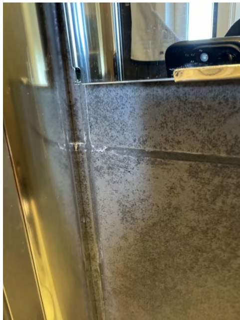
Mindre kalkutslag og normal slitasje.
