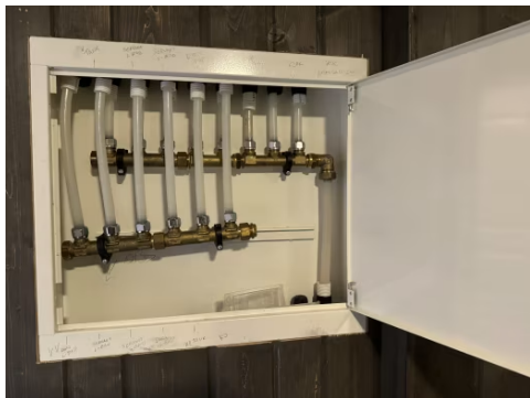
Vannlåsskap i bod.
