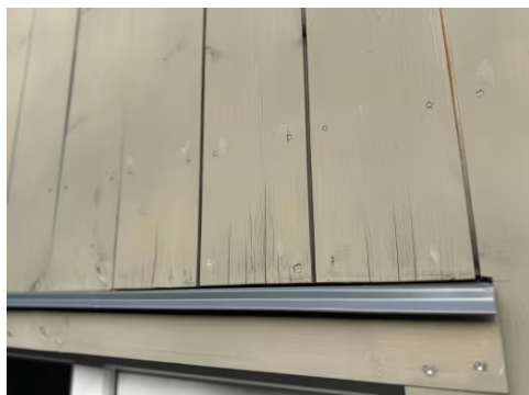
Soltørket og oppsprukket panel.
