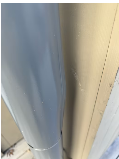
Frostsprenning på nedløpsrør.
