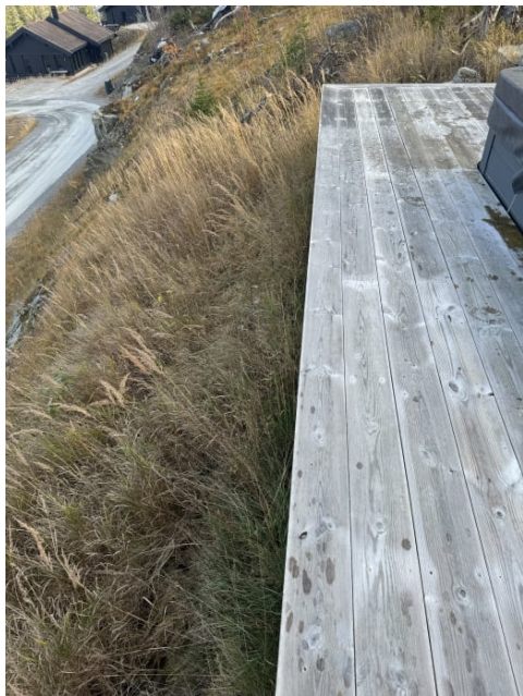
Område med manglende rekkverk og høyde på over 0,5m til terreng.
