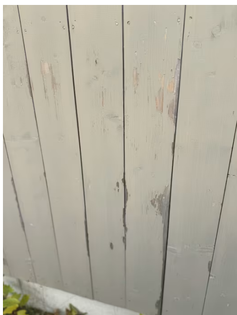
Det er behov for noe overflatebehandling.
